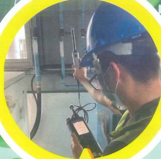
設備機房溫度檢測
