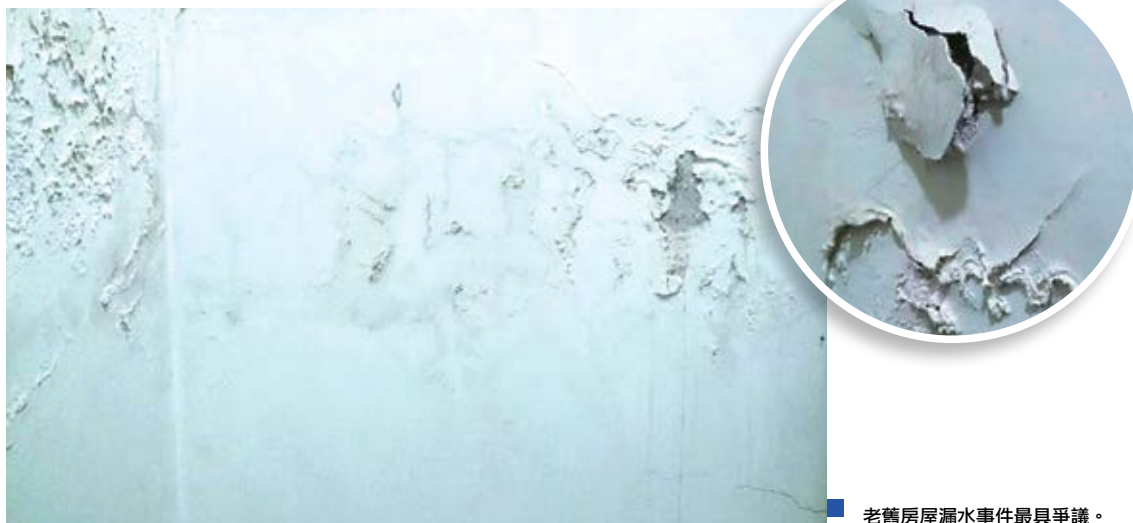
老舊房屋漏水事件最具爭議。
